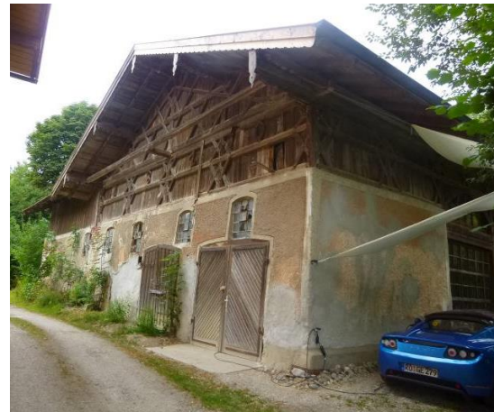
D-1-87-176-15: Bundwerkstadel, umfassend sanierungsbedürftig, Mühlthal 2
