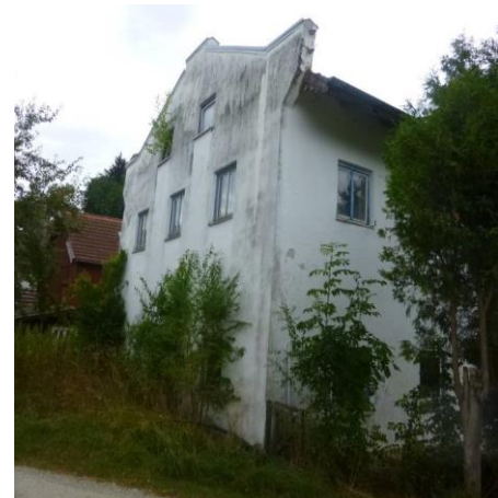
D-1-87-176-17: Ehem. Mühle, umfassend sanierungsbedürftig, Mühlthal 9
