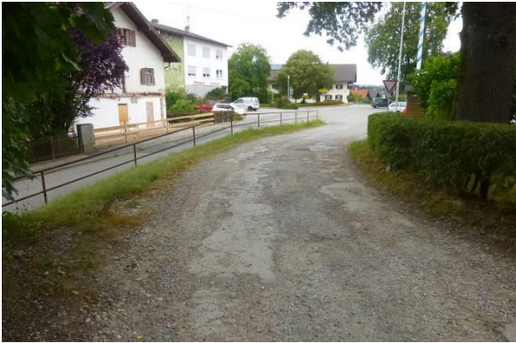
Abb. 86: Zufahrtsweg zum Bahnhof mit schadhafter Oberfläche, eig. Aufn
