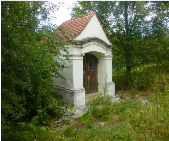
D-1-87-176-18: Wegkapelle, renovierungsbedürftig, Mühlthal 8a
